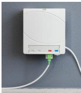
Câbles et boîtier Fibre
